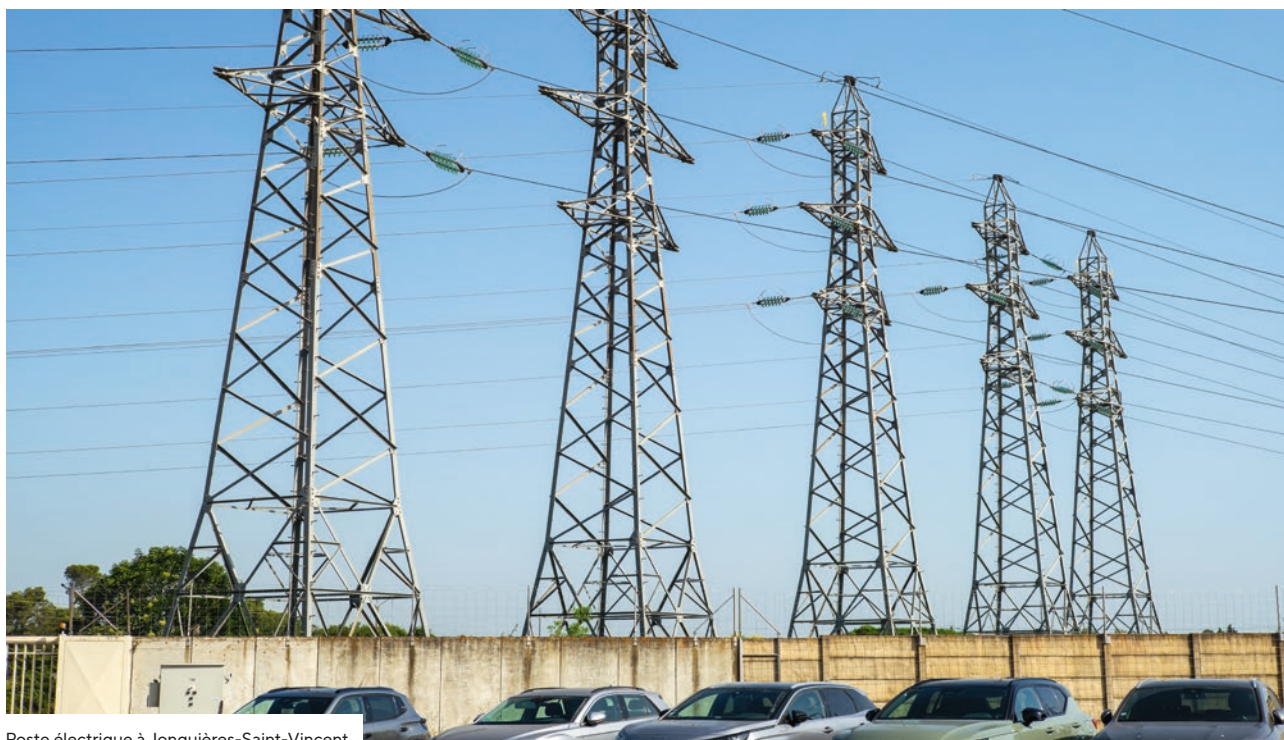
Poste électrique à Jonquières-Saint-Vincent
