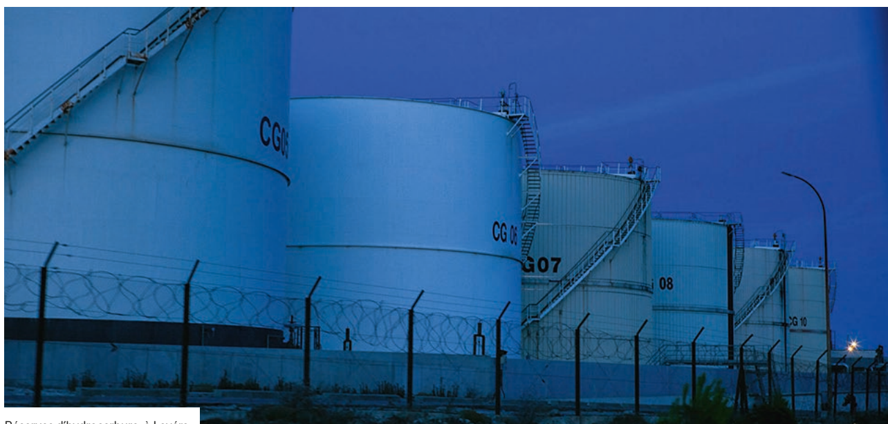
Réserves d'hydrocarbure, à Lavéra
